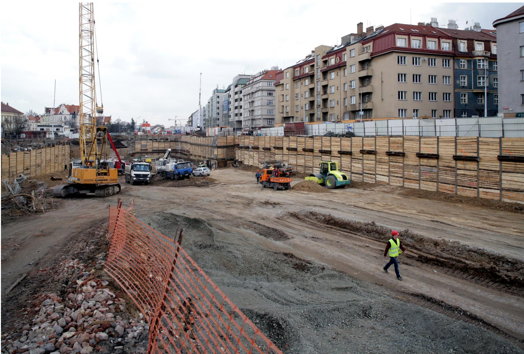
Provádění hloubených tunelů Dejvického tunelu v těsné blízkosti zástavby v ul. Milady Horákové v Praze
